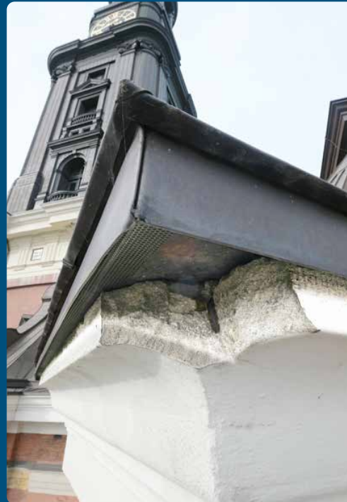
Lockere Betonteile mit einem Gewicht von bis zu 250 kg wurden entfernt.
