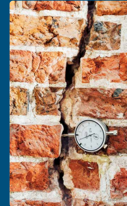
Sogenannte Rissuhren messen die Bewegungen im Mauerwerk.
